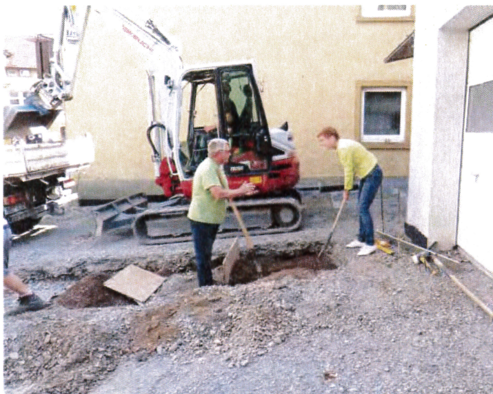
Unternehmer Waldemar Stahl und SPD-Bundestagsabgeordnete Dr. Dorothee Schlegel packten auf der Baustelle fleißig mit an.
